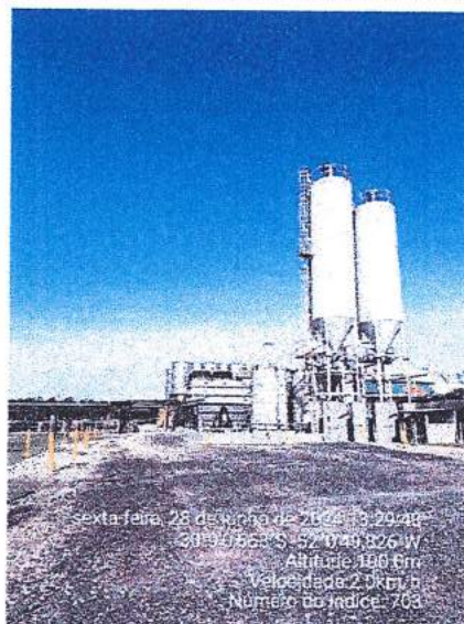
Figura 30: Estação de tratamento de efluentes da unidade.
