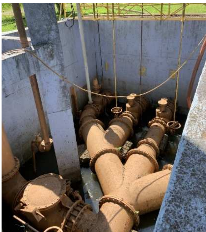
FIGURA 2.21 – Adutoras de Água Bruta 01, 02 e 03
