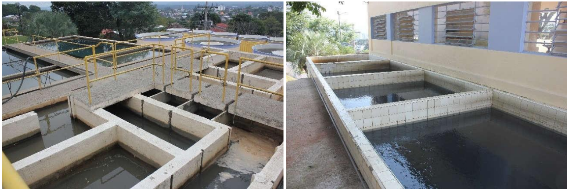
Figura 12: Bloco Hidráulico 2 e quatro filtros de área superficial igual a 9 m 2 /unidade.
