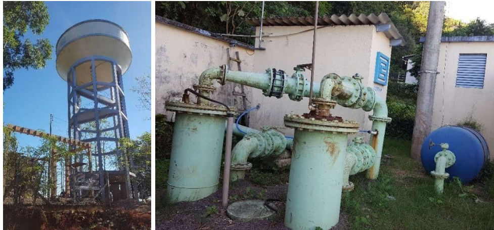
Figura 24: Reservatório R-26 Linha Santa Cruz e EBA-13, Recalque Belvedere.
