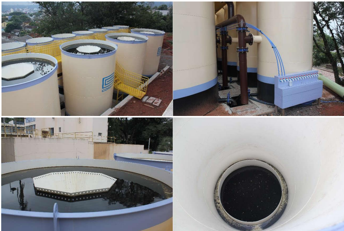
Figura 20: Vista superior dos tanques da ETA compacta em teste de operação, à esquerda superior. À direita, destaque ao aparato de controle para qualidade de água. Abaixo, detalhe para floco-decantador e filtro em testes.
