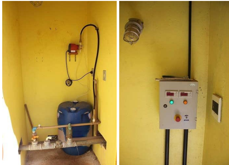
Figura 50: Unidade de Tratamento em Justo Rangel (dosador de cloro).
