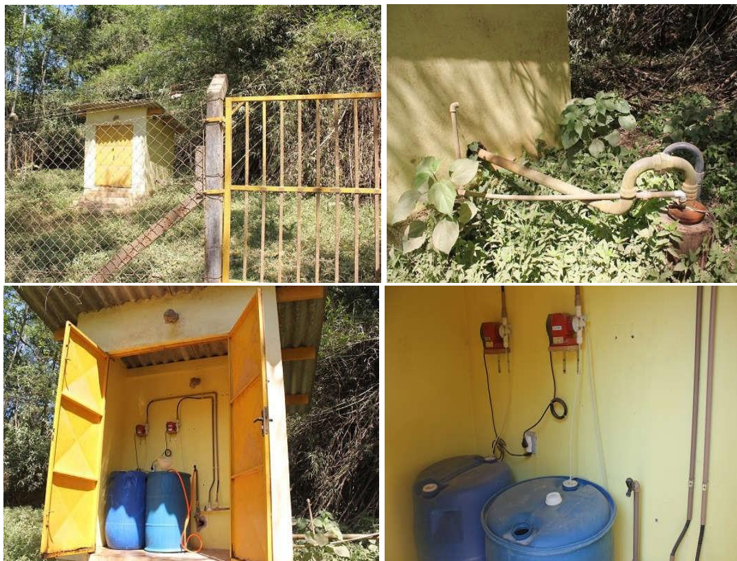
Figura 48: Unidade de Tratamento em Linha Brasil.
