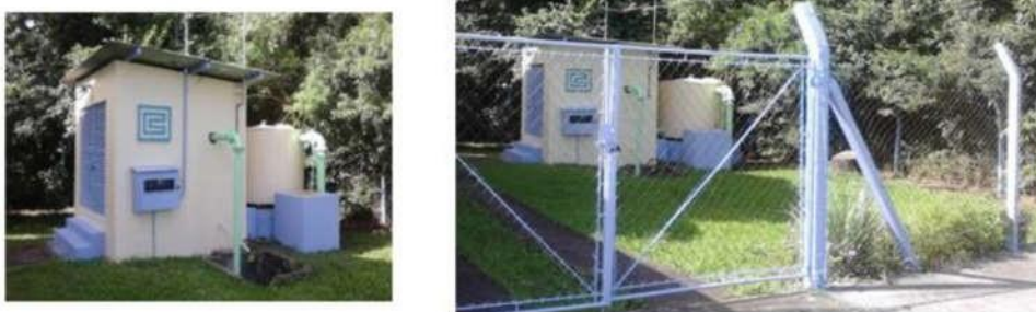
Figura 41: Melhorias em Estações de Bombeamento.
