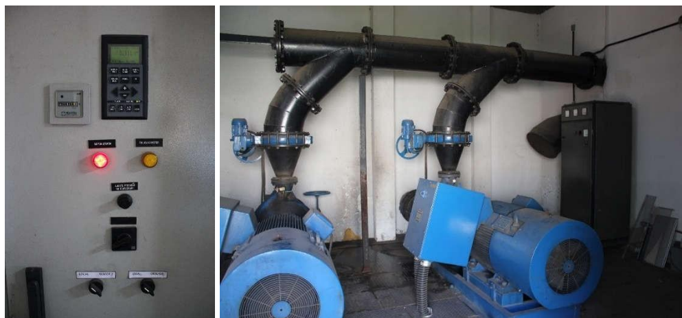
Figura 23: Sistema do 3º recalque na Estação de Tratamento de Água, para abastecimento de água na zona alta da cidade a partir do reservatório 4 (2250 m³).
