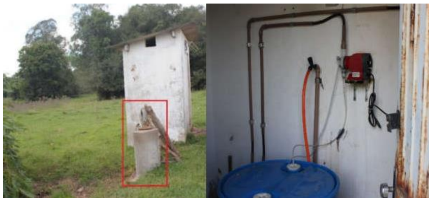
Figura 53: Unidade de Tratamento em Cerro Alegre Baixo I. Fonte: Adilson Becker Jr. (2018).
