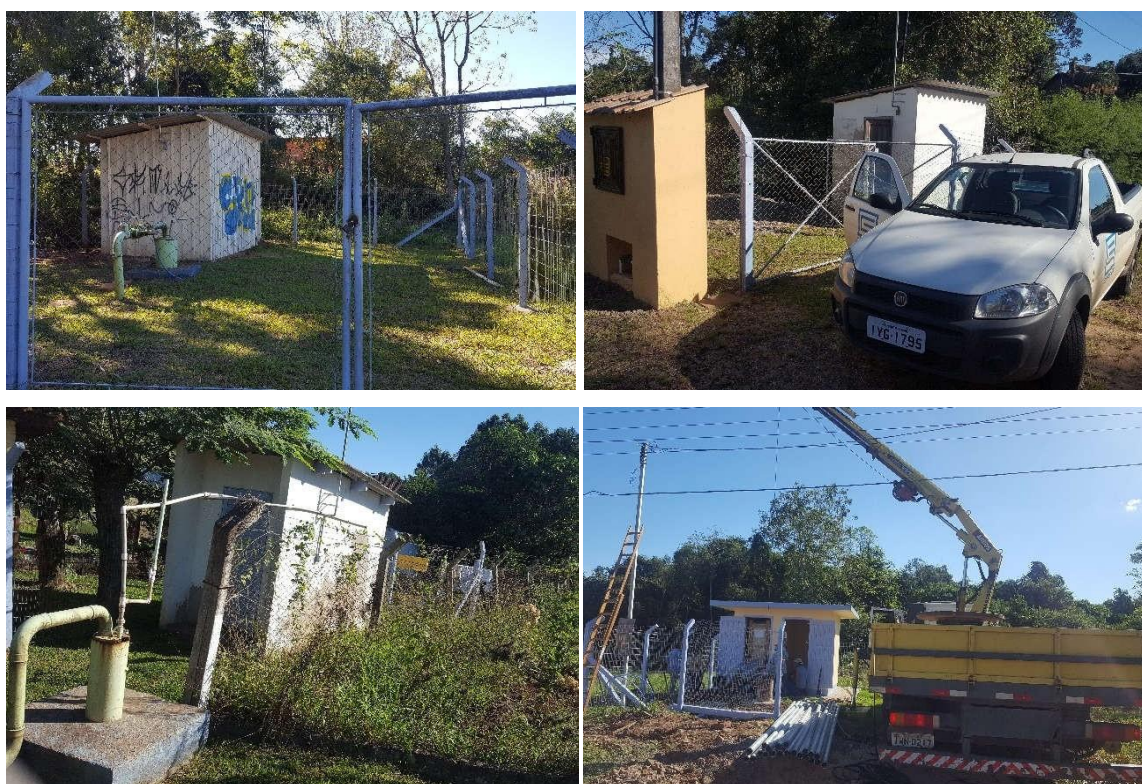
Figura 34: Poços de captação de água subterrânea em Lª Sta Cruz. Destaque para imagem à direita inferior, poço em implementação (Poço Marques). Poço CTG (à esquerda superior), poço boa vista (à direita superior) e Poço Morsch (esquerda inferior)
