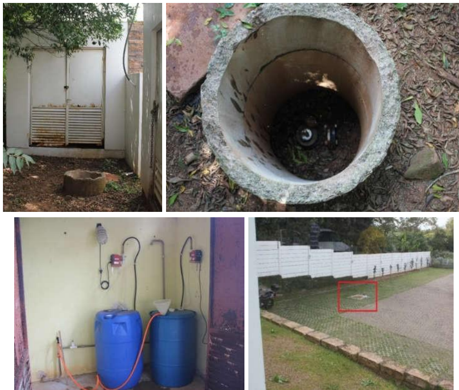
Figura 56: Unidade de Tratamento em Linha João Alves. Fonte: Adilson Becker Jr. (2018).
