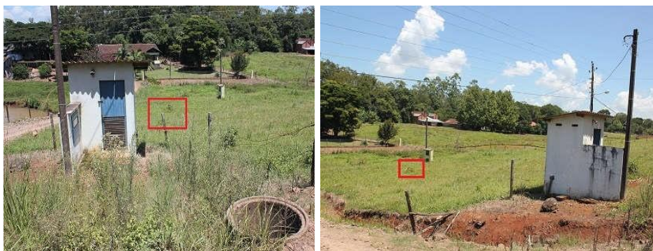
Figura 52 - Unidade de Tratamento em 4ª Linha Nova. Destaque para inadequação quanto a acesso e poço.
