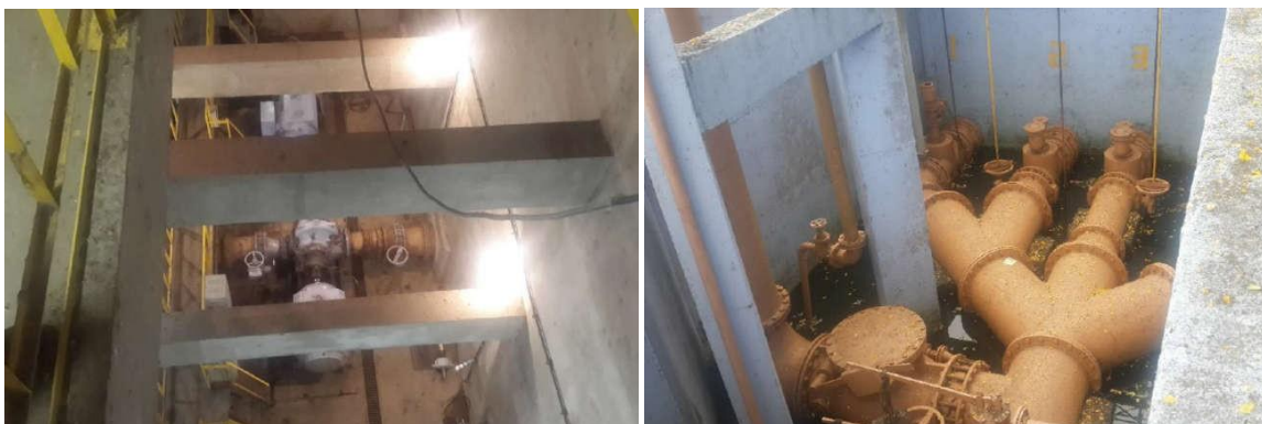
Figura 10: Conjunto de moto bomba da elevatório e saída da elevatória para adução.
