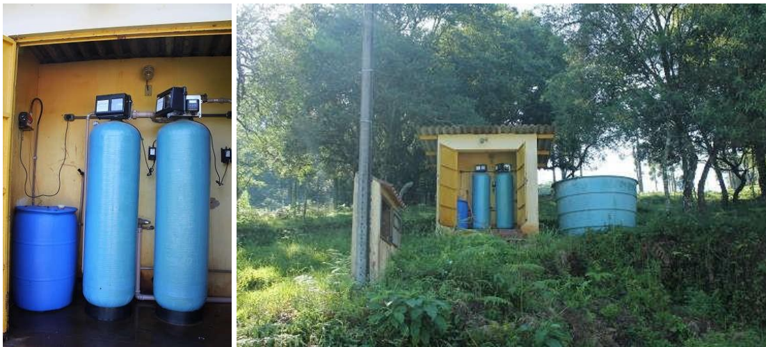
Figura 45: Unidade de Tratamento em Alto Paredão.
