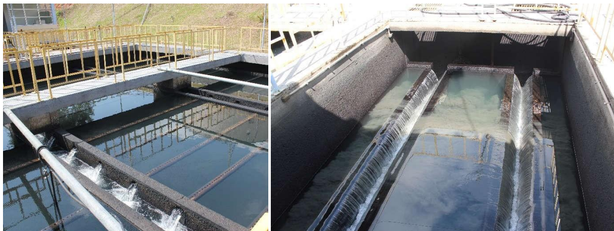
Figura 14: Detalhe do bloco hidráulico 3: Calha coletora de água pós decantação e pré-filtração. A direita, processo de lavagem dos filtros.
