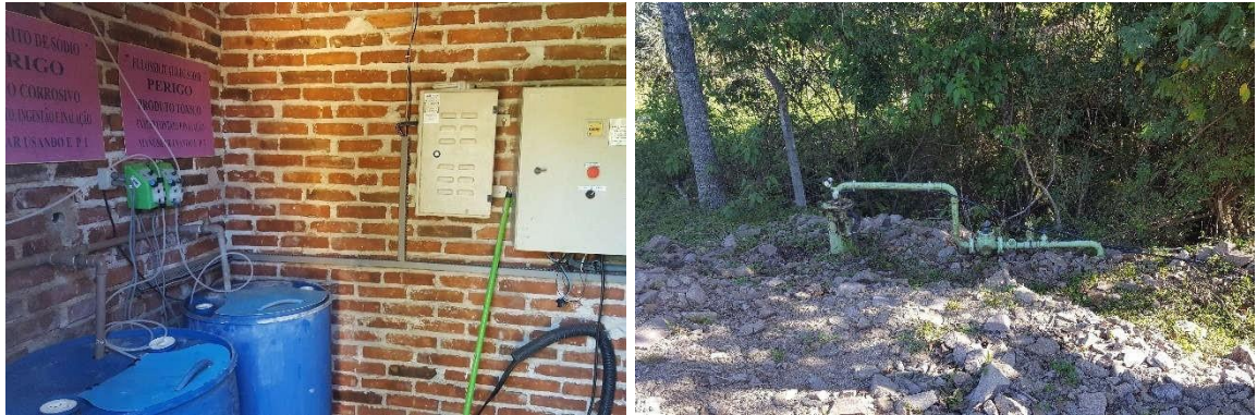
Figura 35: Detalhe para sistema de tratamento e poço Boa Vista.
